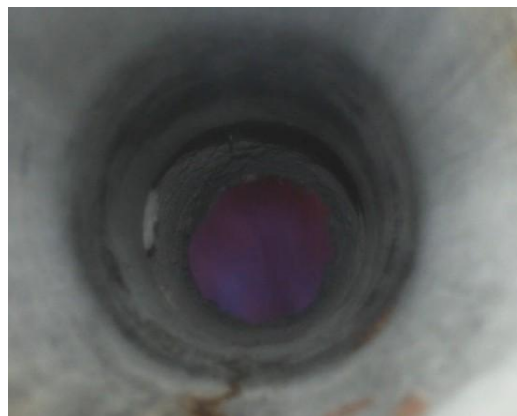
Рис.2 Факел низкоэмиссионной горелки TECHNOFLAME (вид в смотровое окно жаротрубного котла)
